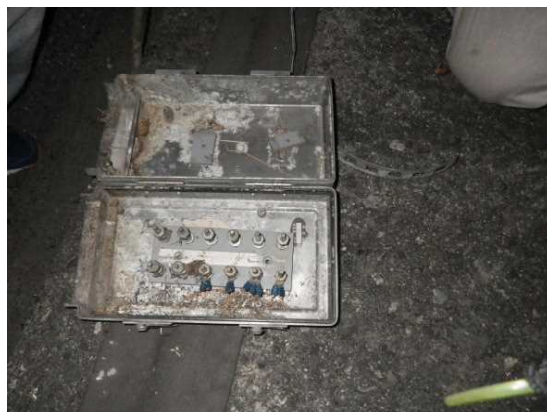
【中継用端子箱内部の営巣状況】
