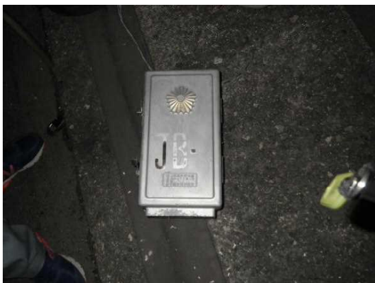
【中継用端子箱の外観】
