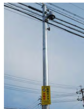
街頭防犯カメラの設置
